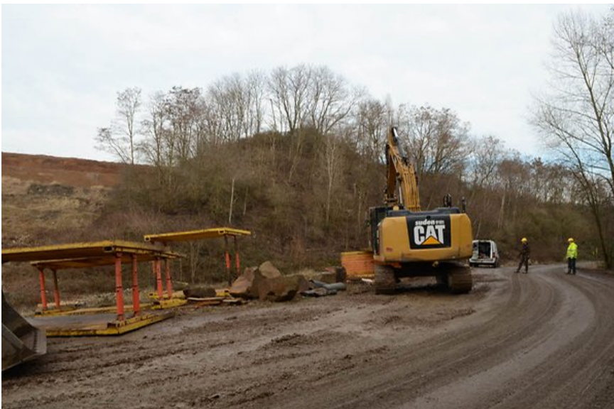
Zu steil ist der Hang des alten Deponieabschnitts 1; hier wird möglicherweise Material angeschüttet.
